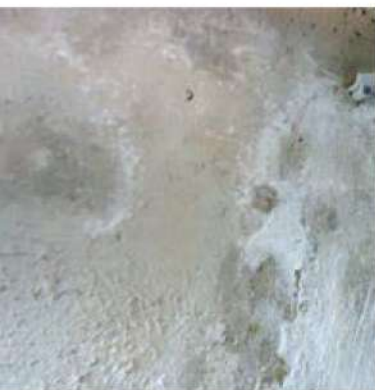
Muratura con umidità di risalita con la formazione di efflorescenza salina prima del risanamento
