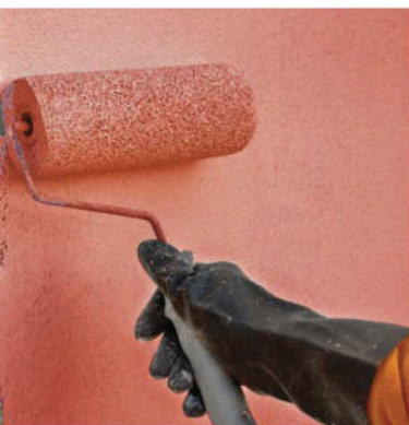
Applicazione a rullo / pennello di una mano di fissativo Primar Silox per rivestimenti ai silossani
